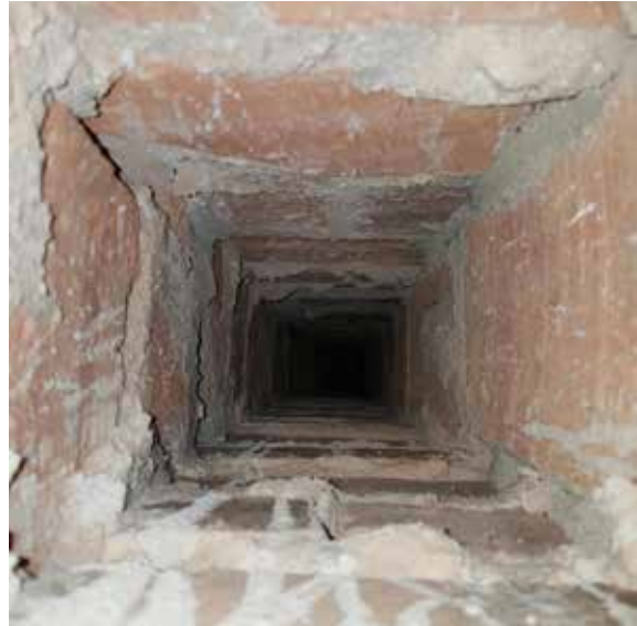
Tegelkanal före tätning
