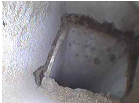
Eternitkanal med väl synliga hålskador
